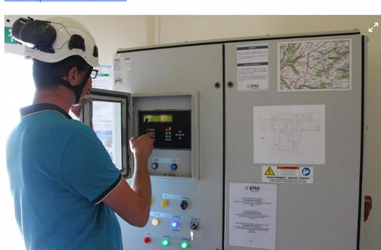
Au pied d'une éolienne, le centre nerveux.
