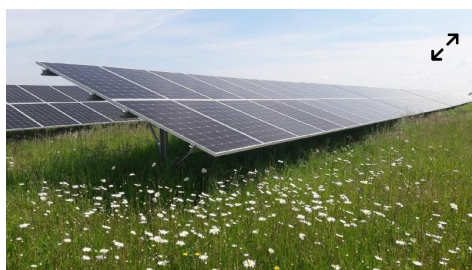
Une partie de l'énergie produite par la centrale Sun'R Power, déployée sur
